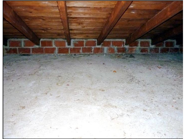
Abbildung 15: Im nordöstlichen Teil des Dachbodens ist der seitliche Abschluss der Dachhaut gemauert.
