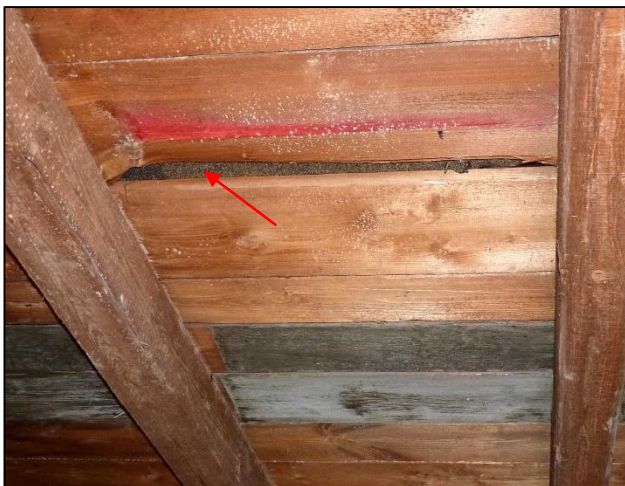
Abbildung 16: Spalte zwischen den Brettern der Dachhaut. Darüber die Dachpappe.
