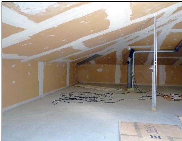
Abbildung 12: Blick in den künftigen Serverraum.
