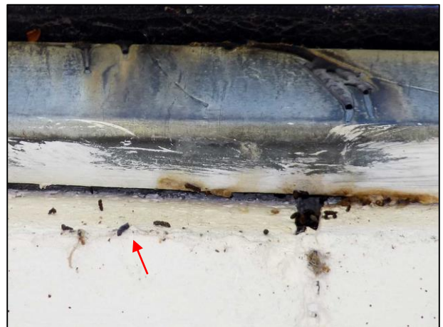
Abbildung 8: Kotkrümel am Einschluß eines mit Zwergfledermäusen besetzten Dachrand-Blechtes (Beispielfoto).
