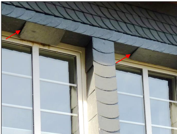
Abbildung 1: Fehlstellen in der Schindelverkleidung über den Fenstern.
