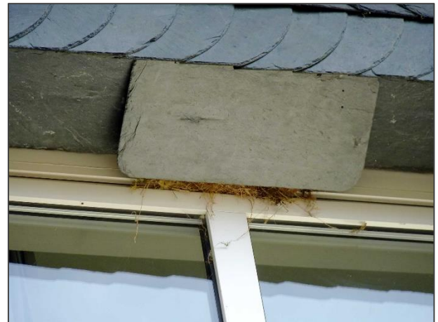
Abbildung 2: Die abstehende Schindel über dem linken Fenster wurde als Brutplatz genutzt.
